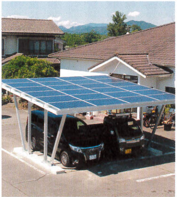
ティーエスが長野・安曇野の出張所に設置したソーラーカーポート
